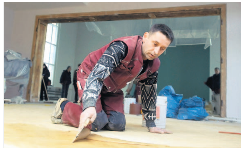
Parkettleger Mirko Berthold gibt dem neuen Boden in den ehemaligen Gemeindesälen der Cottäer Heilandskirche den letzten Schliff. Auch die Außenanlagen werden hergerichtet. Ab Mai werden hier 40 Kinder in einer evangelischen Kindertagesstätte betreut. Fotos: Steffen Unger, Katja Froberg (2)
