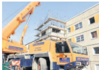
Die Kita auf dem Limbacher Weg in Gorbitz wird schon seit dem letzten Jahr komplett saniert. Die Stadt investiert rund 2,9 Millionen Euro in 25 neue Plätze.
